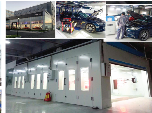
VIMET CUNG CẤP HỆ THỐNG PHÒNG SƠN DÂY CHUYỀN VÀ THIẾT BỊ CHO XƯỞNG DỊCH VỤ MAZDA
